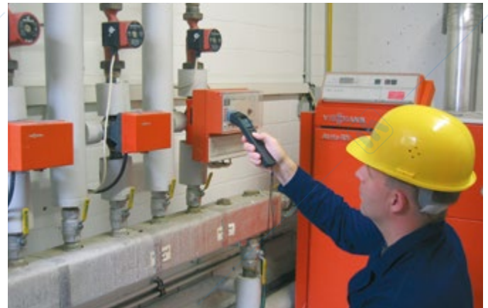
Überprüfen der Temperatur an Heizkreisen
