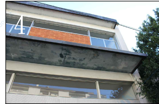
4 Anomalia: tenuta canale di gronda Scheda: 8
