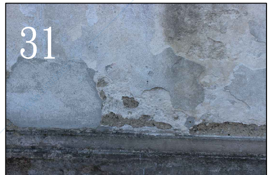
Anomalia: risalita capillare Scheda:3
