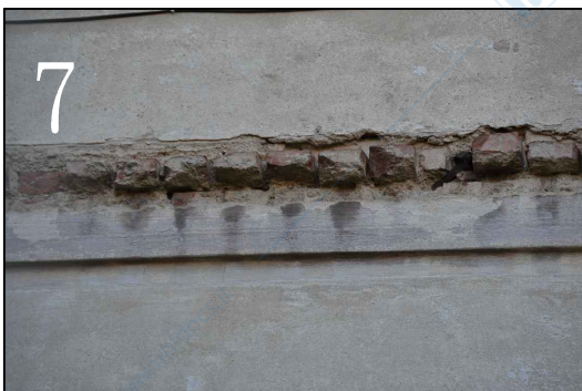
7 Anomalia: dilavamento Scheda: 2
