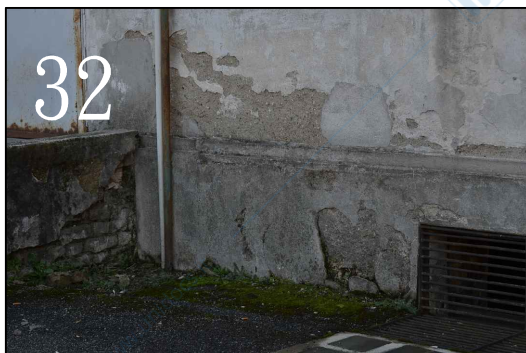
Anomalia: risalita capillare Scheda:3
