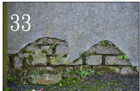
Anomalia: risalita capillare Scheda:3
