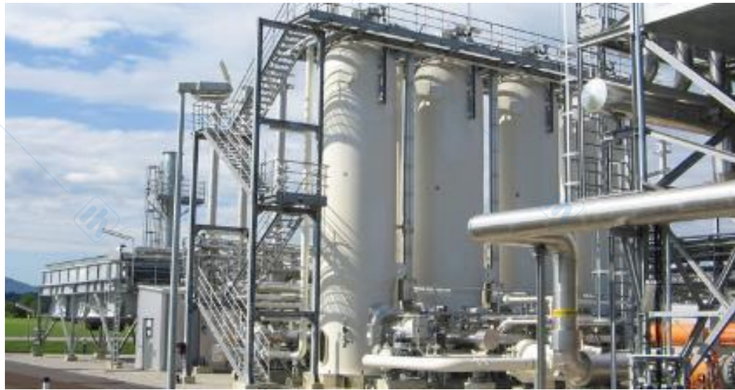
Natural gas dehydration plant - Silica Verfahrenstechnik GmbH
